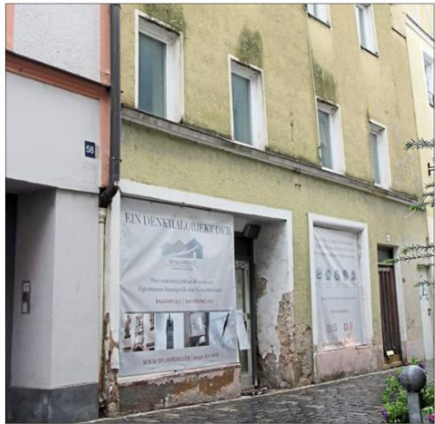
Das heruntergekommene Haus in der Rosengasse hat einen neuen Besitzer. Nun soll es saniert werden.
